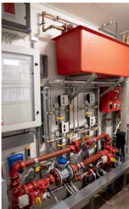
Sprinklerpompkamer Lebuïnuskerk Deventer.
