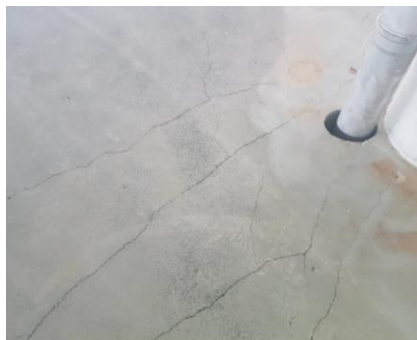
Figuur C.13: Waargenomen scheuren aan de bovenzijde van de vloer.
