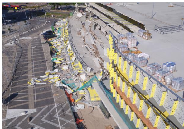
Figuur C.8: Beeld van de brokstukken buiten het gebouw.
