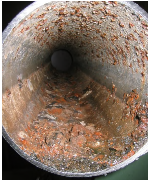
Figuur 2: Inwendig gecorrodeerde sprinklerleiding. (bron: KWA Bedrijfsadviseurs BV)
