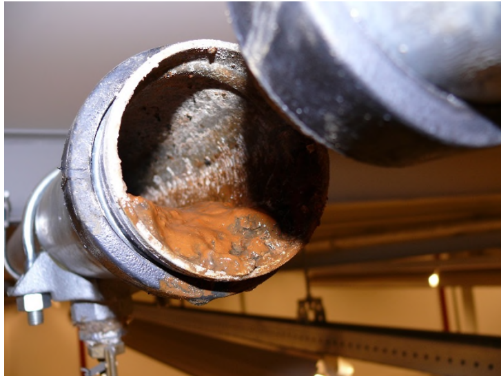
Figuur 6. - Drab in een sprinklerleiding (bron: KWA Bedrijfsadviseurs BV)
