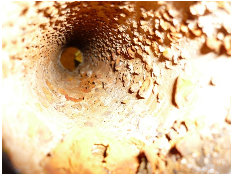
Figuur 3: verruwing van het oppervlak van leidingen. (bron: MIC-Europe BV)
