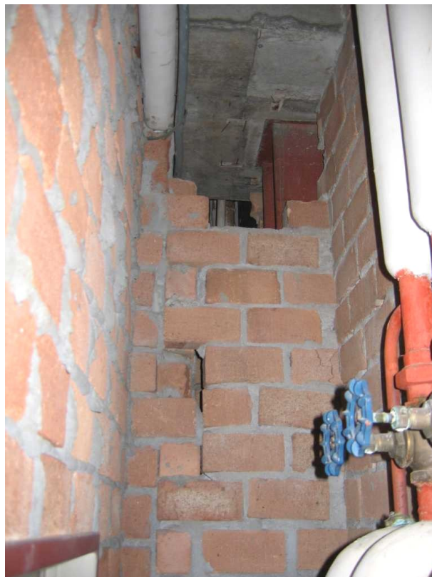
Foto 8: Gat in brandwerende wand van verticale leidingschacht.
