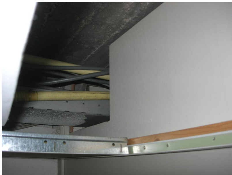
Foto 4: Niet brandwerend afgewerkte brandscheiding boven het plafond.
