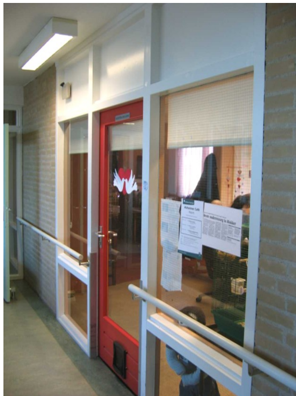
Foto 10: Kunststof kattenluikje in niet-zelfsluitende deur en te veel draadglas in brandwerende scheiding.
