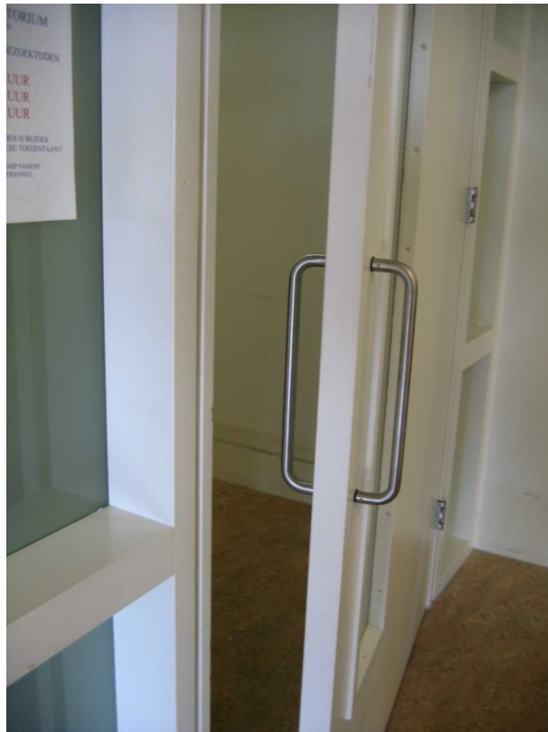
Foto 21: Niet goed sluitende, zelfsluitende deur in brandscheiding.
