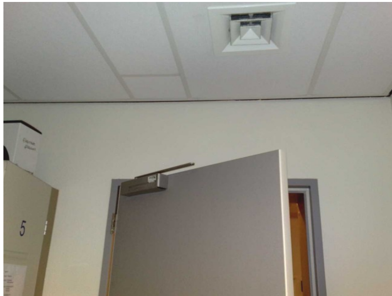
Foto 19: Losgemaakte deurdranger bij zelfsluitende, brandwerende deur.
