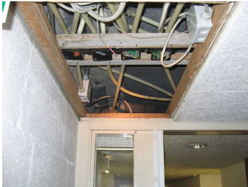
Foto 7: Ontbrekende brandscheiding boven plafond.
