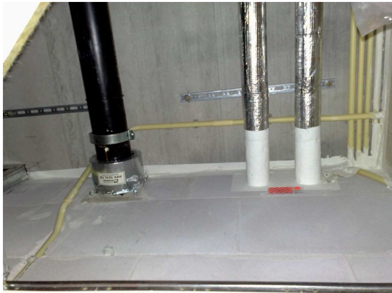
Foto 5: Goed afgewerkte doorvoeren door brandwerende scheiding.
