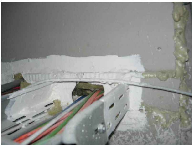
Foto 6: Nieuw gat in brandwerend afgewerkte doorvoer door brandscheiding.
